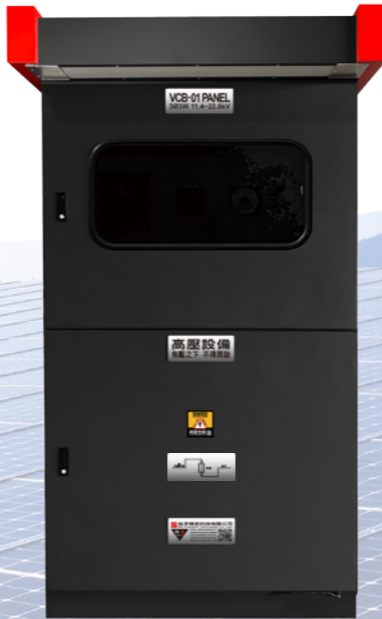
太陽能系統VCB PANEL
